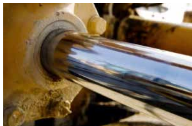
Slika 5 : Poškodba tesnil zaradi pojavnega »dizel efekta« znotraj HV
